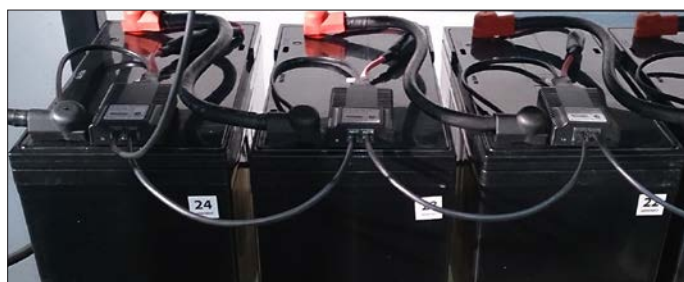
Moduły BACS zamontowane na akumulatorach.
