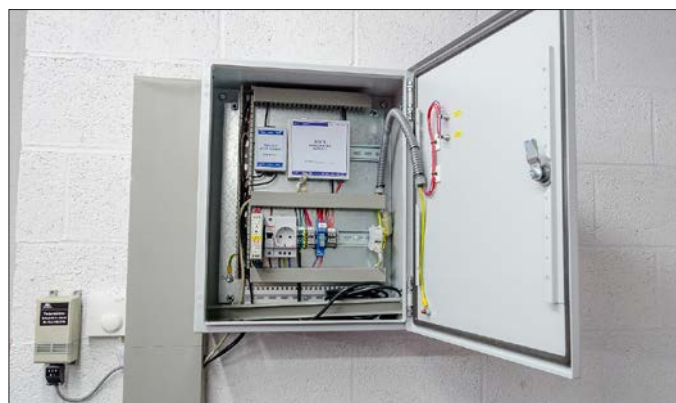
Szafa sterownicza BACS
