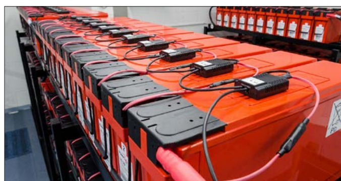
Moduły BACS zainstalowane na bateriach typu „Front terminal”
